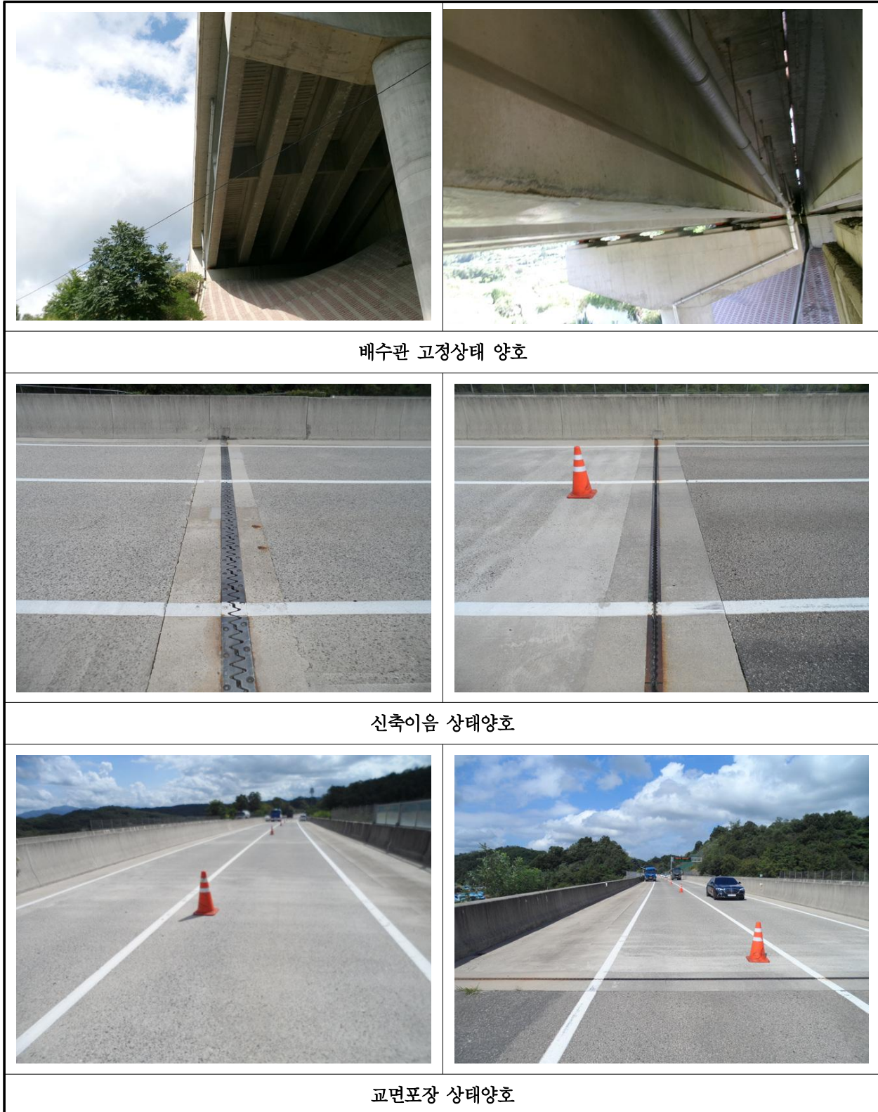
【사진 27.3.53】 교량의 공중이용시설 10대 위험요소 손상현황(계속)
